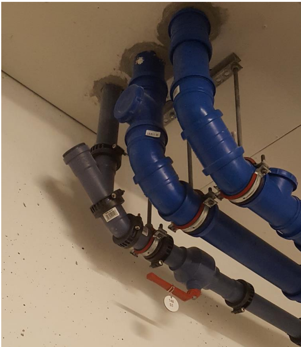
Synliga och åtkomliga proppade ändar i rörsystemet bör vara säkrade.
